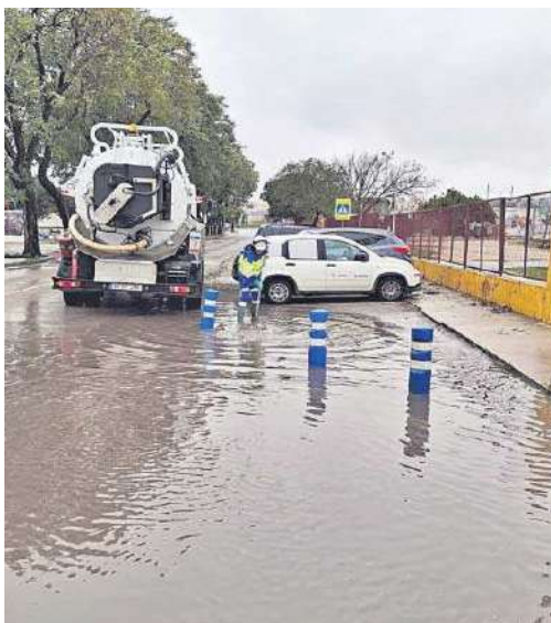
Un operario municipal, desatascando una pocetilla.
