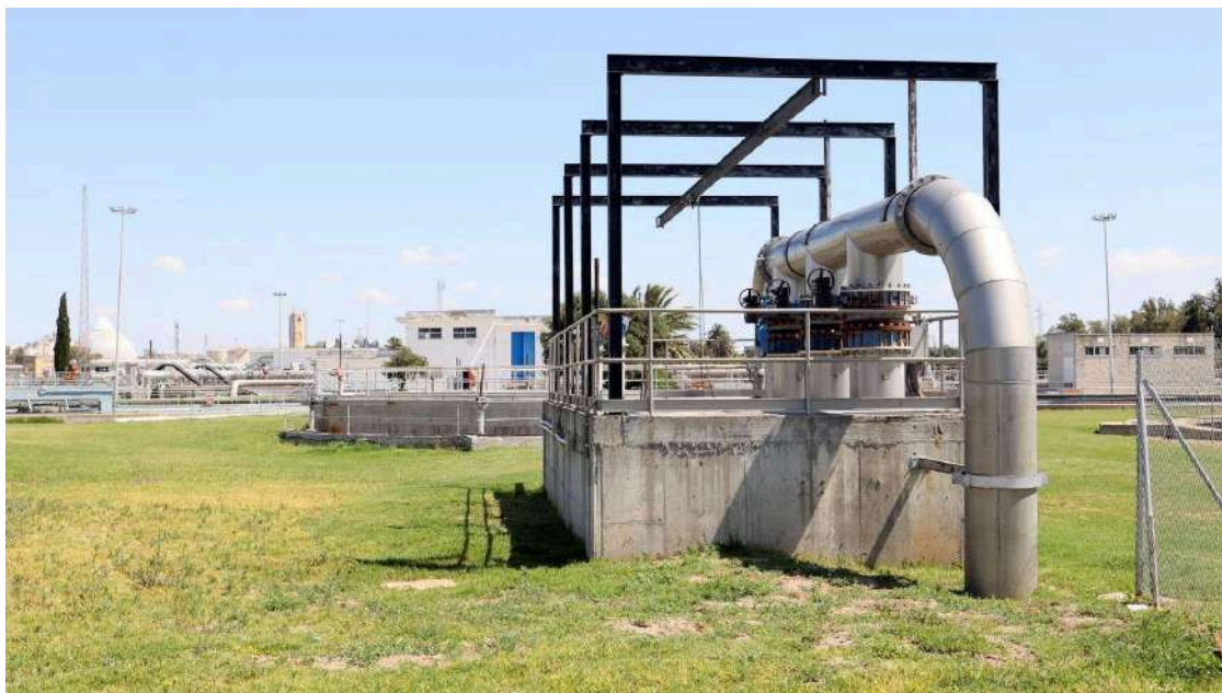
Imagen de la estación depuradora de El Portal
